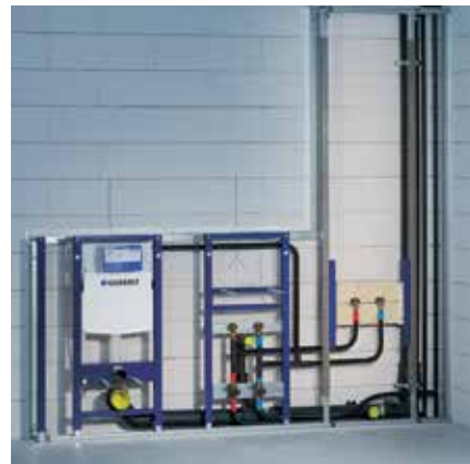
↑ 현대 기술을 사용한 벽매립형 물탱크
